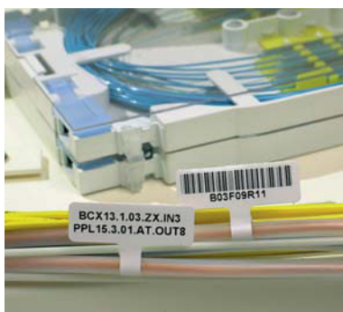
Fähnchen für Glasfaserkabel
